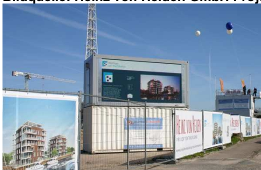
Digibox in Cuxhaven Quelle: Heinz von Heiden / Floor Seven
